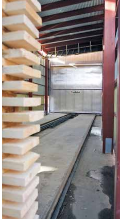
Ein Valutec-Kanaltrockner beim Sägewerk Barthel Pauls Söhne ist in Betrieb
