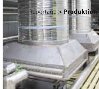
Wärmetauscher in den ersten fünf Zonen dienen der Energierückgewinnung
