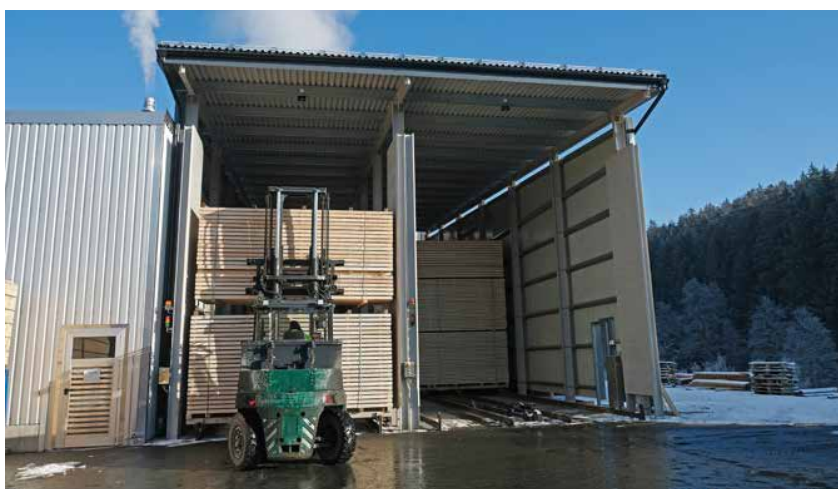
Vor der Kammer installierte Valutec einen überdachten Puffer. Damit kann die Anlage am Wochenende mannlos weiterlaufen
